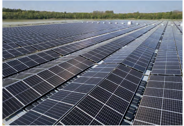
Bild 7.1 – Floating-PV-Anlage in Haltern am See (Quelle: © TU Dortmund)
