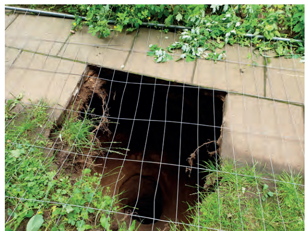
Bilder 10.3 und 10.4 – Tagesbruch neben einem Wohngebäude
