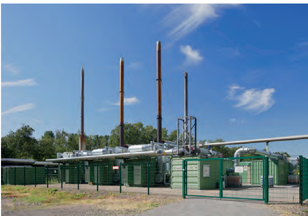
Bild 2.1 – Grubengasverwertungsanlage (Quelle: Friedhelm Krischer)
